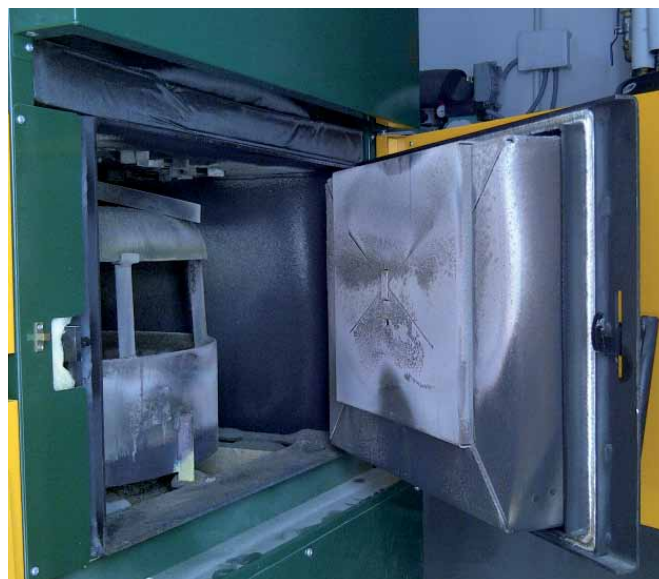
Caldera en la guardería municipal de Sanxenxo.
