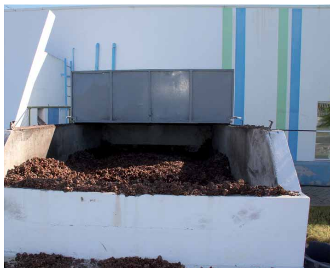
Vista del silo de la caldera de la piscina.
