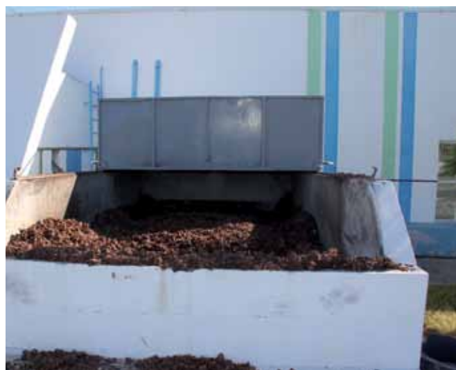
Silo de armazenamento da biomassa florestal da piscina municipal de Alcácer do Sal.
